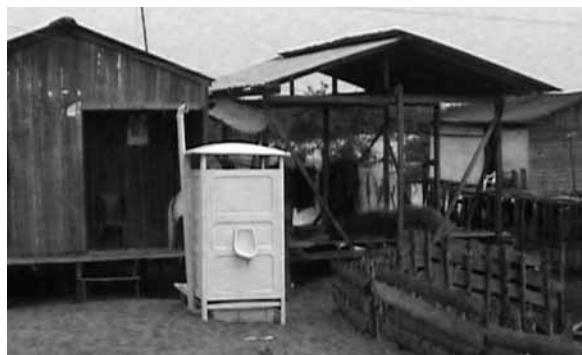
Figura 4. Sanitario Ecológico Seco instalado fuera de la vivienda. Barrio Candamo (Tumaco).
