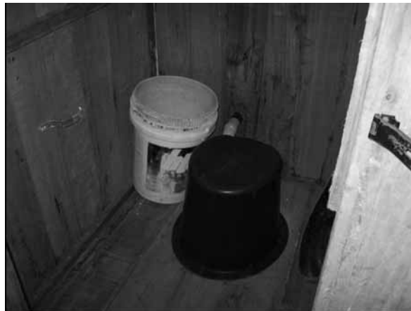
Figura 10. Sanitario Ecológico Seco. Brisas del Poblado (Quibdó).
