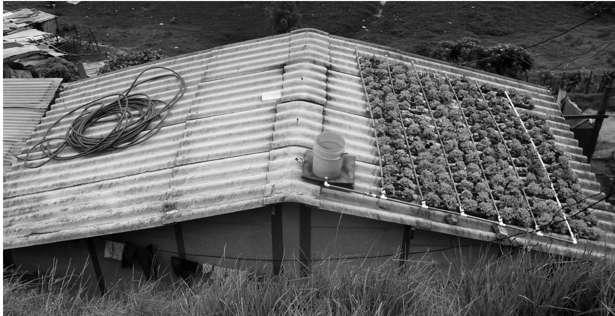
Figura 4 Sistema de conducción, área efectiva 12 m 2 , teja de fibrocemento con ondulaciones
