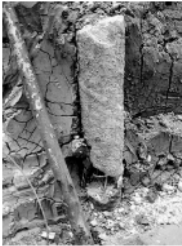
Figura 1. Pilote defectuoso fundido in situ
