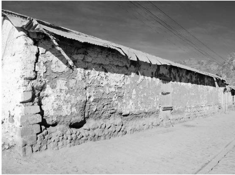
Figura 1: Vivienda en la localidad de Putre en la Región de Arica y Parinacota. Es evidente su nivel de deterioro que acrecentó el daño sísmico durante el terremoto de 2005
