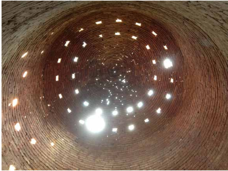
Figura 20: Una vez vaciado el horno después de la quema, entre hornada y hornada, el capelo y la falca vistos desde el interior del horno ofrecen una imagen única y excepcional que condensa el gran valor identitario que tienen estas estructuras y sus oficios.
