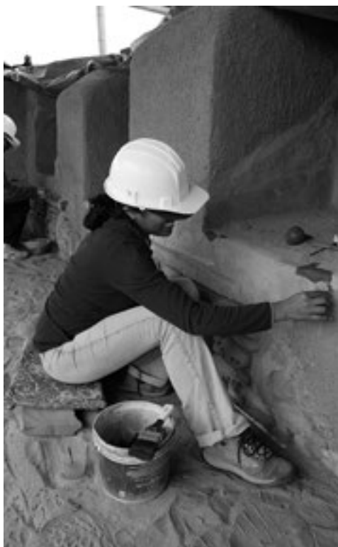
Figura 3: Restitución de revoques con barro en el Palacio Tschudi, Chan Chan, Perú.
