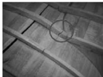
c) Falla en la zona de los lunetos
