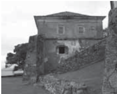
Figuras 22 y 23: Quartel da Tropa, en Santa Cruz de Anhatomirim, 2005. Restauración de un tramo de revoque y capeamentos de los contrafuertes. Estado de la pared antes y durante los trabajos de interven- ción que se están realizando.
