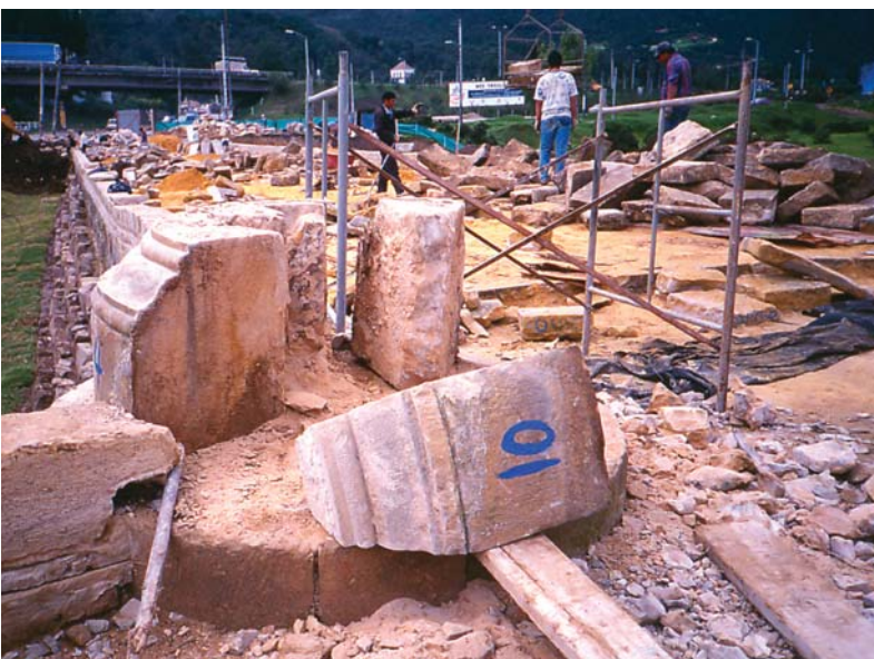
Proceso de reposición de la capa de piedra desgastada de uno de los machones del antepecho del puente. 1997.
