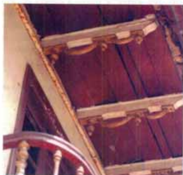
Canes en la casa de la calle 2 entre carreras 6 y 7.
