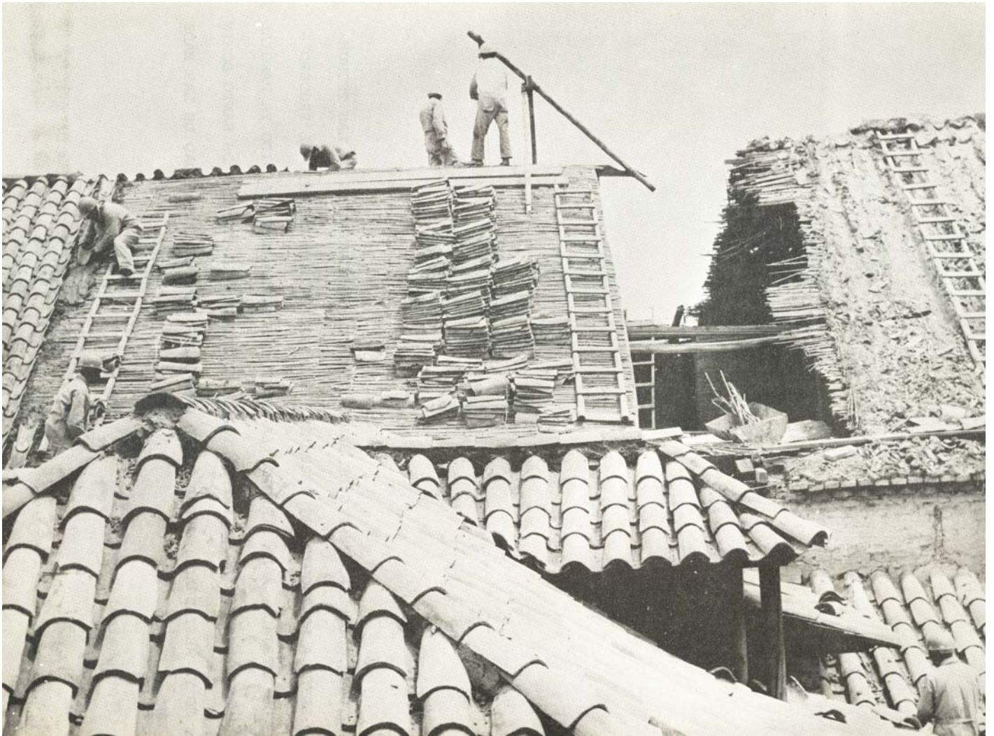
Tunja, Colombia, Templo de Santo Domingo. Restauración de las techumbres. A la izquierda, techumbre del presbiterio durante el proceso de entejado; a la derecha, la techumbre de la nave ha sido ya parcialmente desmontada. En primer plano, tejado de la capilla de Santo Domingo ya restaurado. Fue preciso reemplazar la casi totalidad de las maderas (foto Rafael Rojas)
